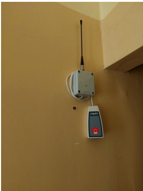
Zdjęcie 12: wysoko położona sygnalizacja alarmowa w izolatce chorych ze zwiniętym kablem od przycisku przyzywowego.
