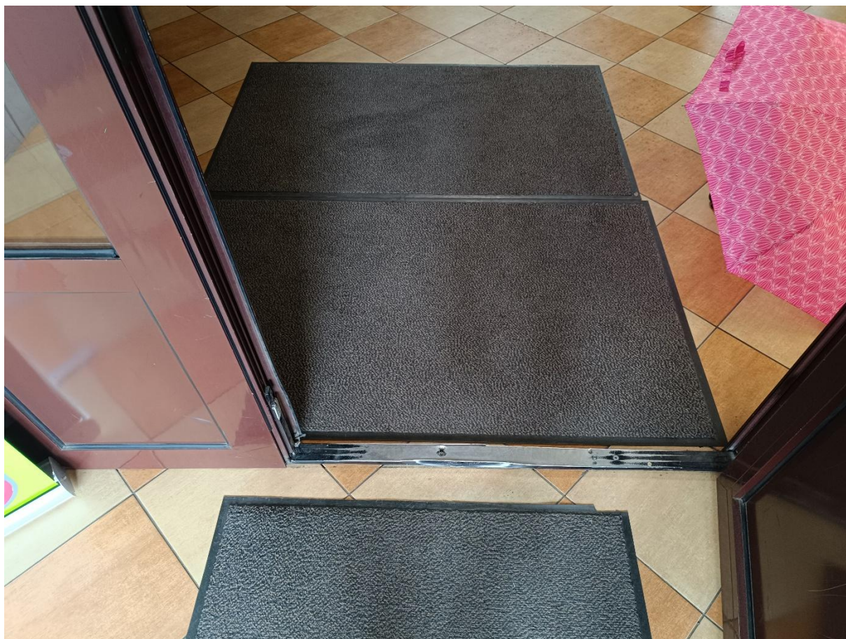
Zdjęcie 8: Odklejające się wycieraczki przy wejściu do budynku powodujące ryzyko upadku.
